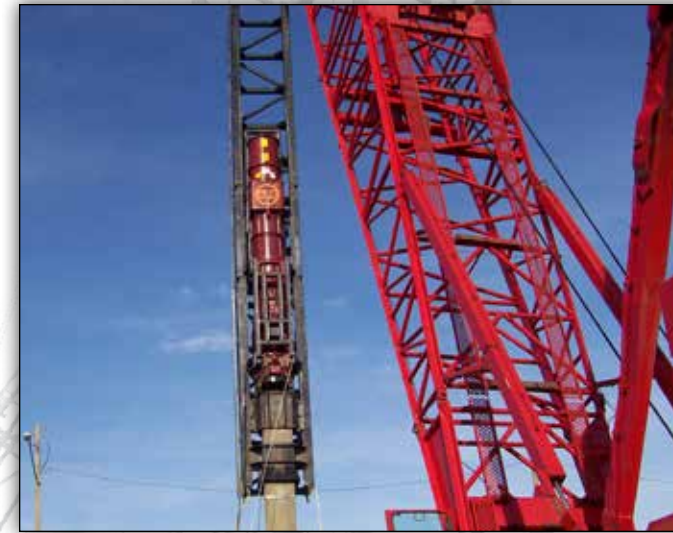
UN D160 DE APE HINCA UN PILOTE DE CONCRETO CUADRADA DE 30" EN OCEAN CITY, NJ.
